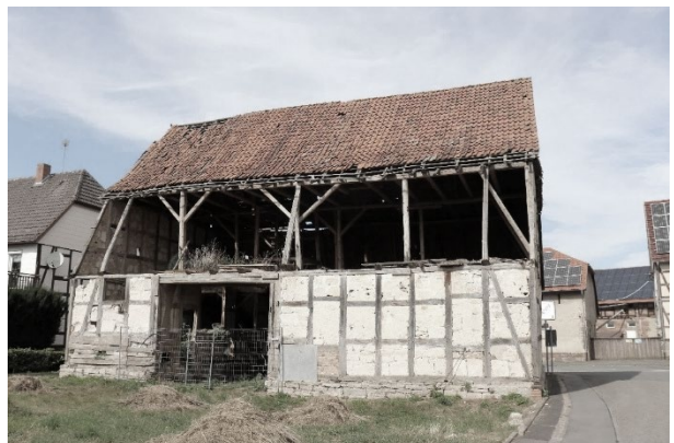
Abbildung 15: Städttebaulicher Missstand "Zehntscheune" in Obermeiser (Quelle: Eigene)
