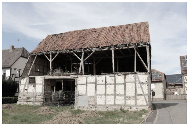
Abbildung 15: Städttebaulicher Missstand "Zehntscheune" in Obermeiser (Quelle: Eigene)
